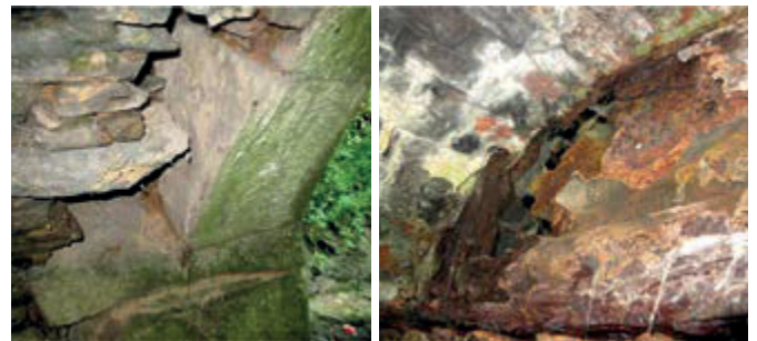
Quelques exemples d'ouvrages communaux en piètre état.
